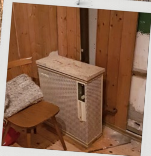
Die alte Heizung hat endlich ausgedient.
